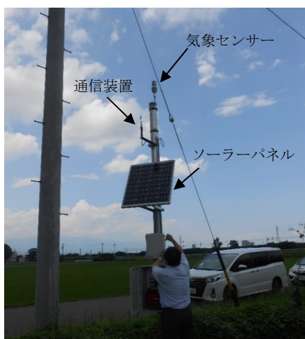
写真-2 LPWA 無線基地局（子局）
